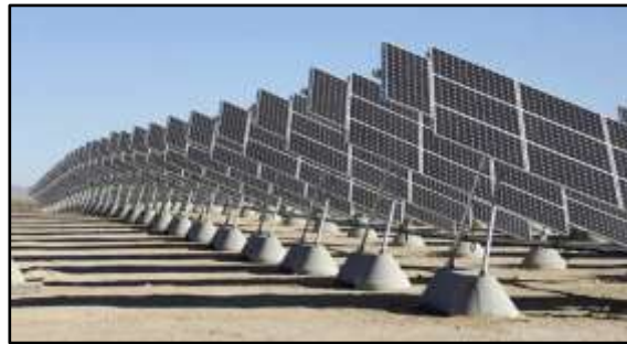
(d) Ballast mounted solar PV
